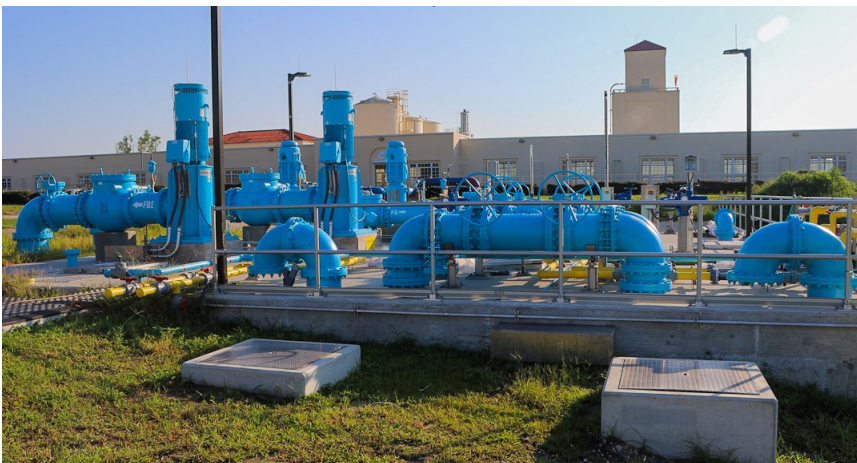
Nueva cuenca de contacto con cloro de alta tecnología para reemplazar el sistema de mezcla de productos químicos de 50 años de antigüedad.
